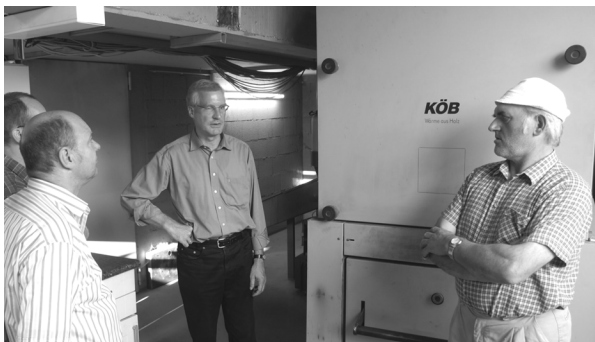
Heinrich Nadler, Josef Loy und Ulrich Schuster (v.l.n.r.) vor der Anlage im Gewerbegebiet.
